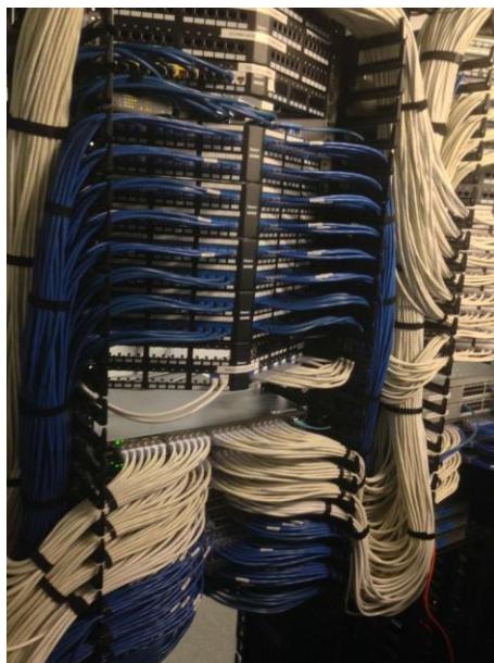
Figure 18 : Exemple de « cable management »
