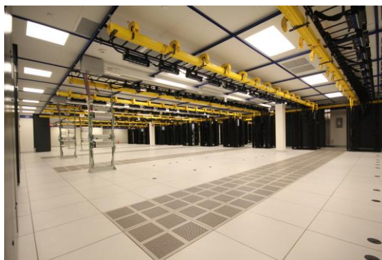
Figure 16 : Salle d'un datacenter avant déploiement
