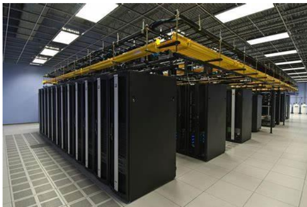
Figure 19 : Salle complètement déployée
